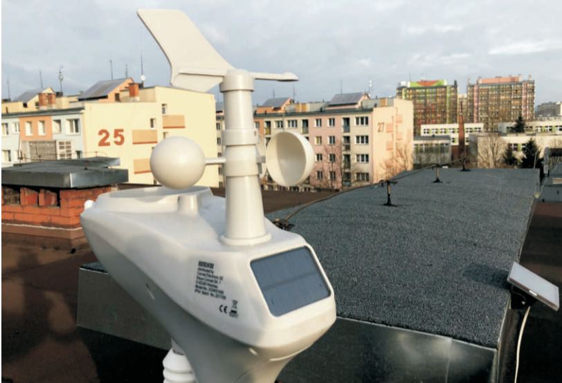
Stacja pogodowa na budynku nr 19 przy ulicy Ludomira Różyckiego.
